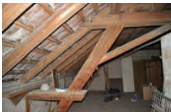
Abb. 112: 1. Dachgeschoss über dem Wohnteil, Blick nach Westen mit dem liegenden Dachstuhl in Q6.
