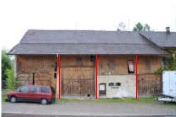
Abb. 38: Südliche Trauffassade mit vierzoner Ökonomie, bestehend aus Futtertenn, Stall, Tenn und Remise (v.r.n.l.). Die westlichste Querzone unterscheidet sich durch die Gestaltung des Tores, dass keine Segmentbogenform aufweist und daher jünger ist.
