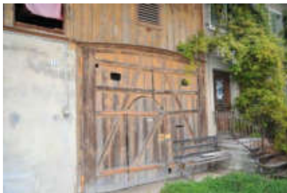
Abb. 45: Südliche Trauffassade, Tor zum Futtertenn (ehemaliges Tenn) in Segmentbogenform und mit Mannstüre.
