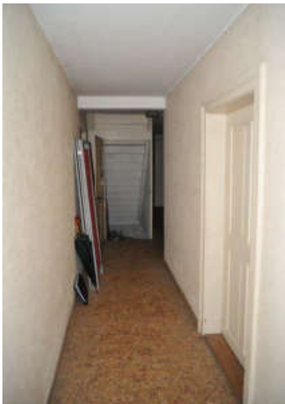
Abb. 69: Korridor 001, Blick nach Norden an die Treppe zu UG / OG. Rechts die Tür zur Stube 002.
