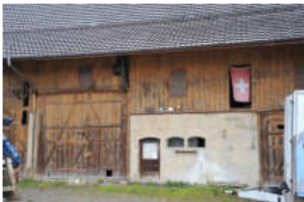
Abb. 44: Südliche Trauffassade, Ökonomie mit Futtertenn, Stall und Tenn (v.r.n.l.). Sämtliche Öffnungen (Fenster, Türen und Tore) verfügen über einen segmentbogenförmigen Sturz.
