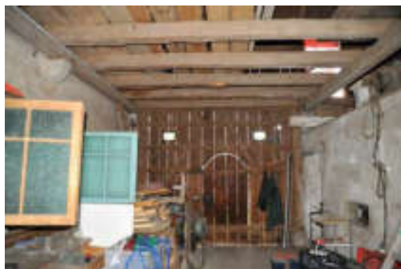
Abb. 116: Futtertenn mit Balkendecke / Garbendiele nach Süden. Rechts die Mauer zum Stall, links die Scheidewand zum Wohnteil.
